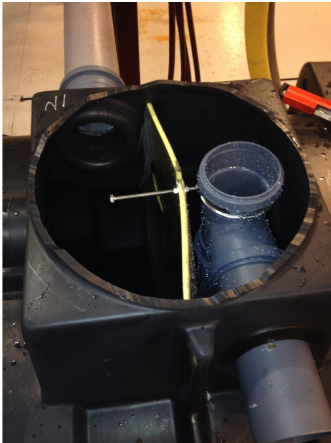
Figur 1 Slamavskiljaren fotograferad ovanifrån. Inloppet till vänster, gul skiljevägg med 110 mm genomföring i mitten och utlopp med T-rör till höger.
